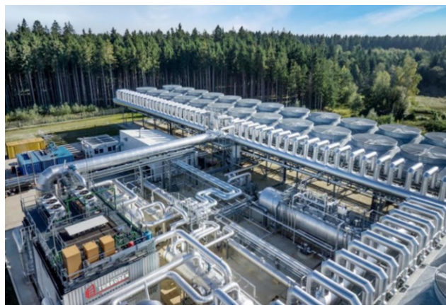
Figure 11: Centrale géothermique de 4MW en Allemagne (Turboden)
