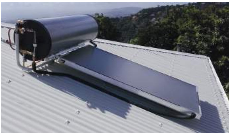
Figure 151 : CESI à thermosiphon sur toiture tôle
