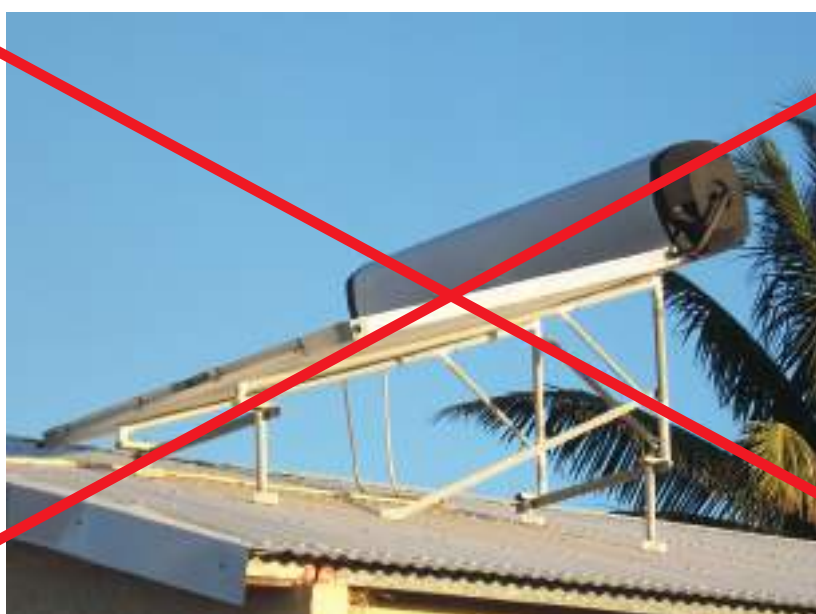
Figure 153 : Exemple à éviter d'installation non parallèle à la toiture et avec système d'ancrage « fait maison »
