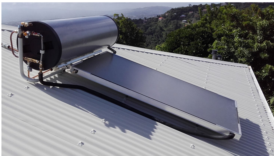
Figure 157 : CESI à thermosiphon sur toiture tôle
