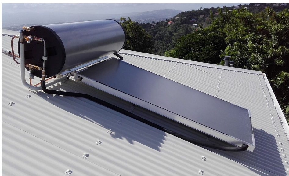
Figure 203 : CESI à thermosiphon sur toiture tôle
