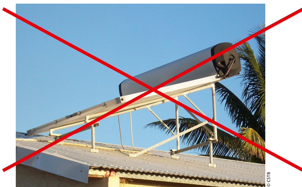
Figure 205 : Exemple à éviter d'installation non parallèle à la toiture et avec système d'ancrage « fait maison »
