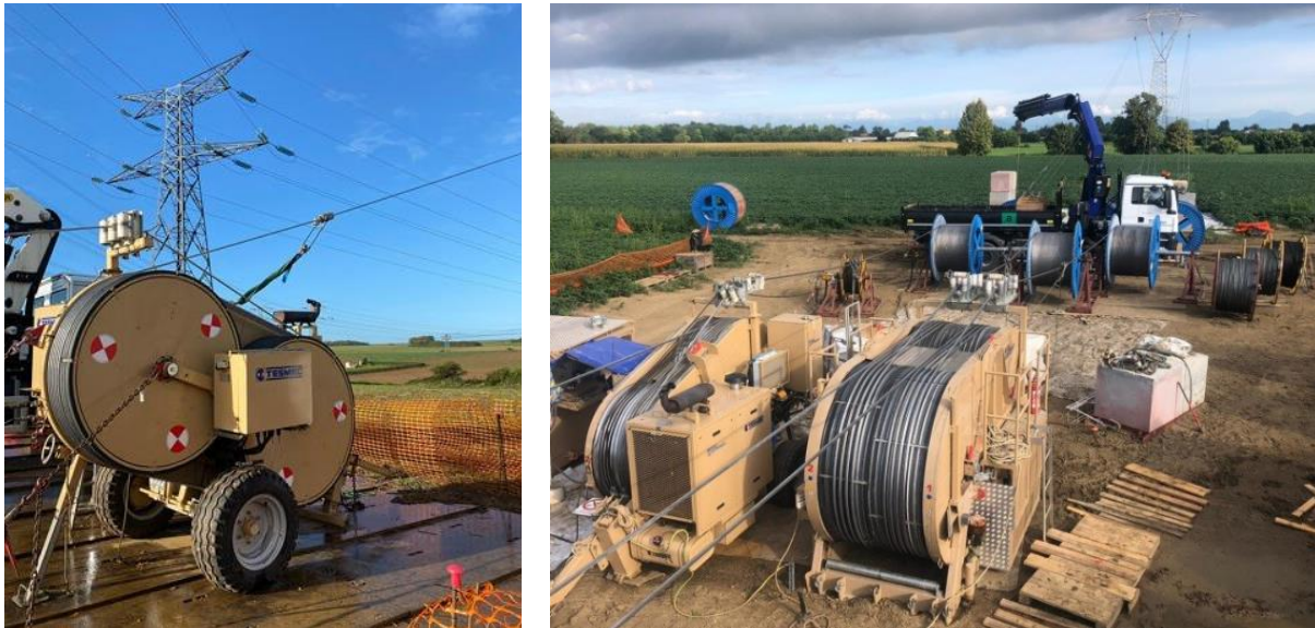
Figure 28 : Plateformes de déroulage
