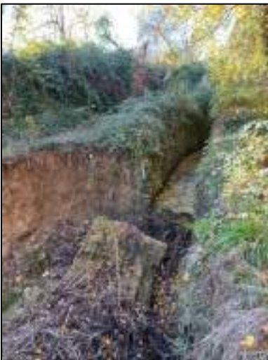
Ancien ouvrage ruiné sur la Fosse (28/11/2024)
