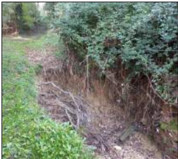
Erosion à l'aval du ruisseau de la Plaine (25/03/2025)
