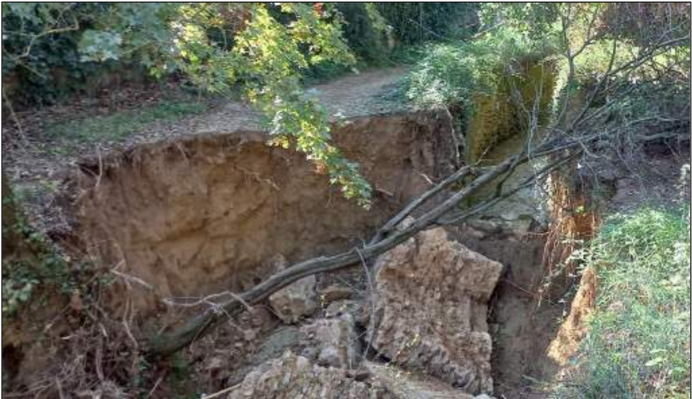
Figure 16 : Ouvrage effondré sur le ruisseau de la Fosse
