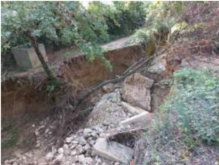
Figure 33 : Pont aval éffondré (Source : Vinci)
