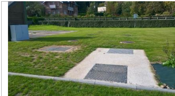
Vue sur les trappes
